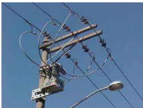
Figure 27- ENERGISA Comptage HTA sécurisé
