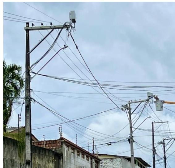
Figure 24- ENERGISA Sécurisation des zones à risque PNT généralisé / exemple de structures
