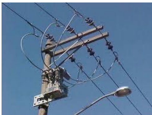
Figure 27- ENERGISA Comptage HTA sécurisé
